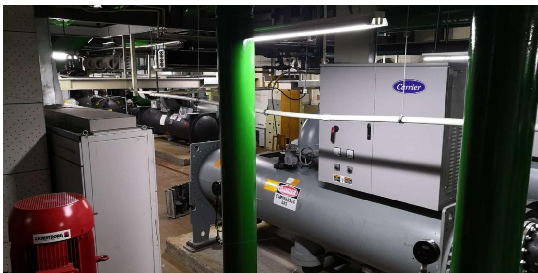
图 2 地下室的冷冻机房单冷式离心机组 4 台机组
